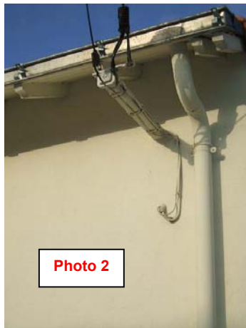
Câble de branchement, vu de près
