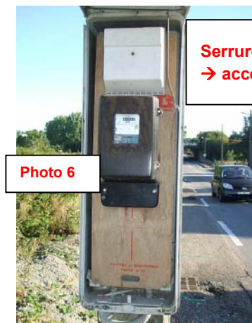
Coffret sur poteau, ouvert
