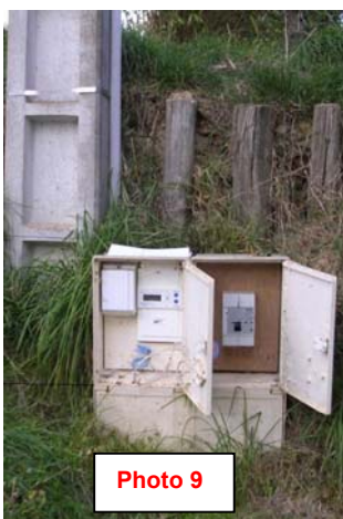
Compteur et disjoncteur dans coffrets extérieurs (généralement dos à dos)
